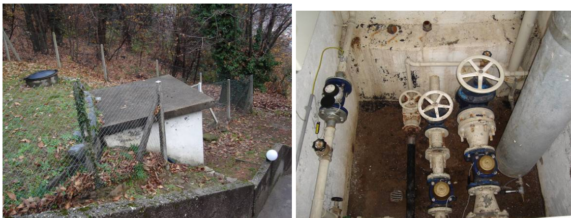
Foto: serbatoio di Cimo e camera tecnica serbatoio di Cimo
