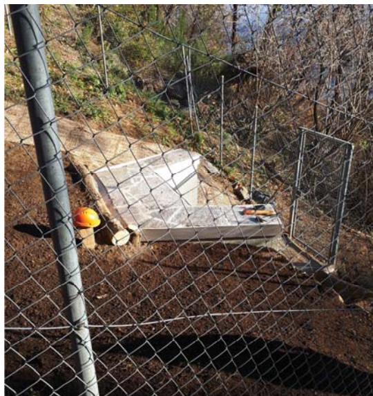
Vista dell'entrata della captazione
