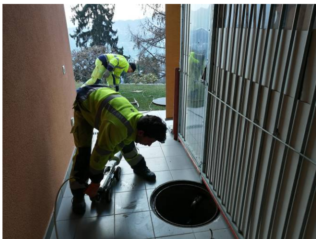
canalizzazione nel mappale no. 725
