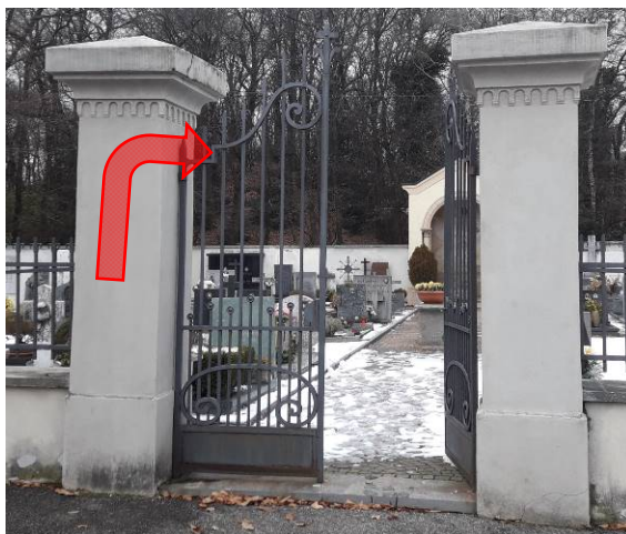
Movimento pilastro lato ovest (lato Chiesa)
