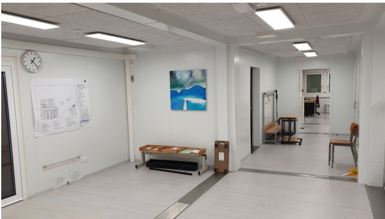
Zona futuro 2° atrio ingresso – da eliminare pareti ufficio direzione, aula sostegno ed entrata aula docenti
