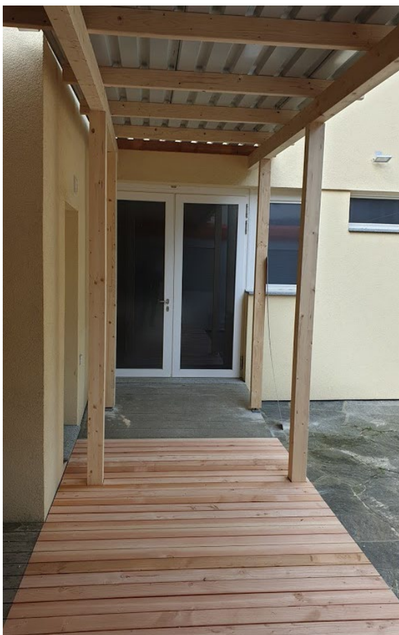
Estensione terrazzo e tettoia tra stabile prefabbricato e cucina S. Maurizio (19.05.2020)
