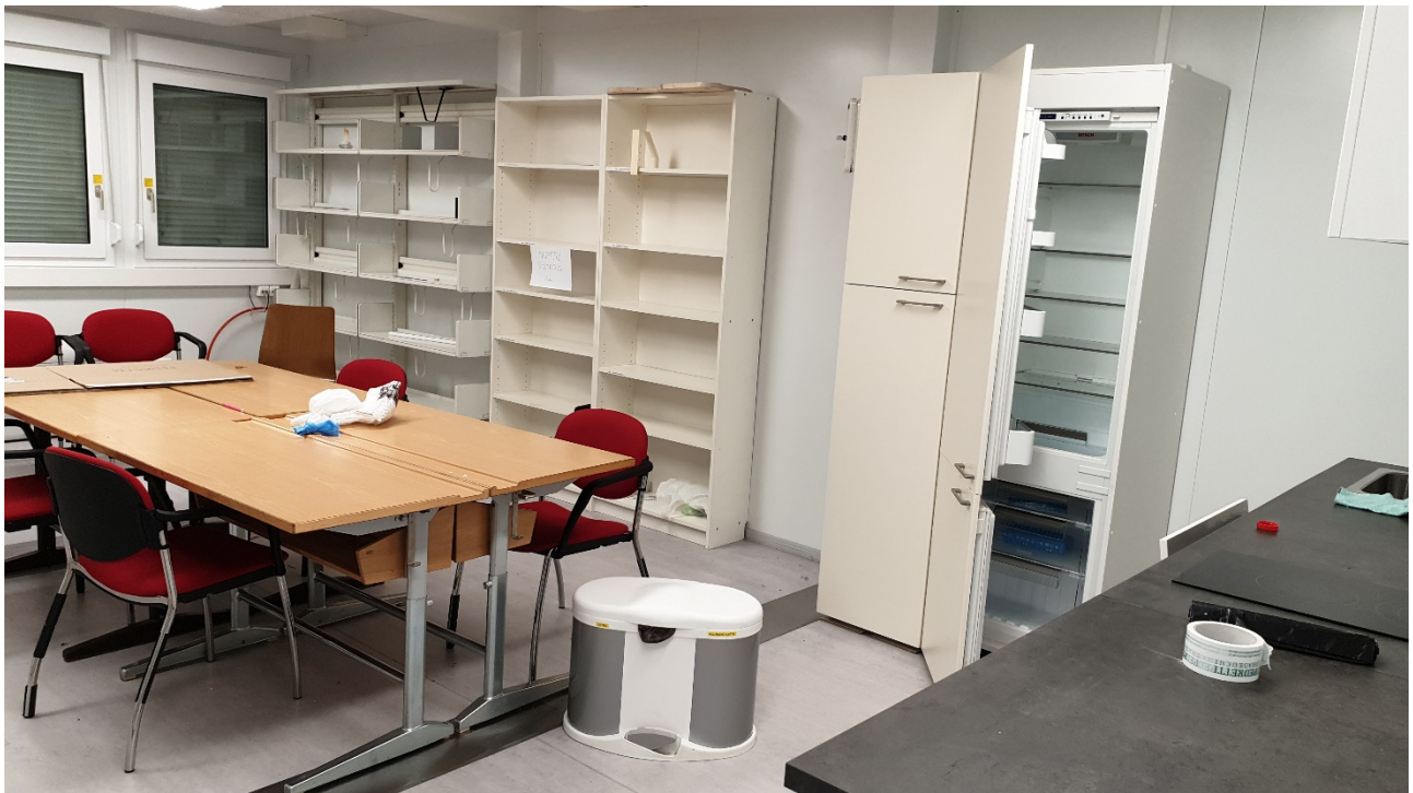
Spazio aula docenti che sarà “traslato” di un modulo, con l’eliminazione di una parete e la costruzione di due nuove
