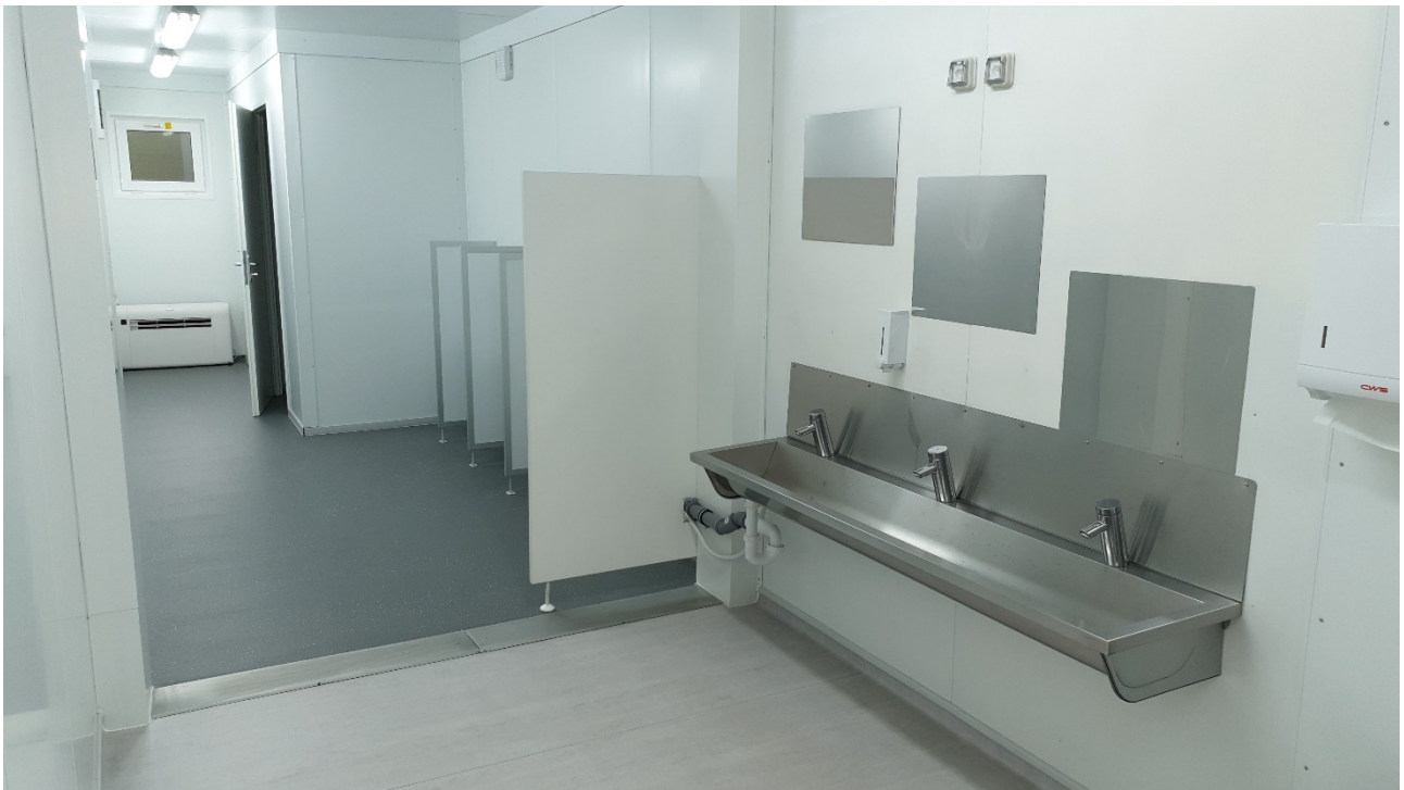
Bagno bambini che verrà smantellato e riattrezzato a misura SI
